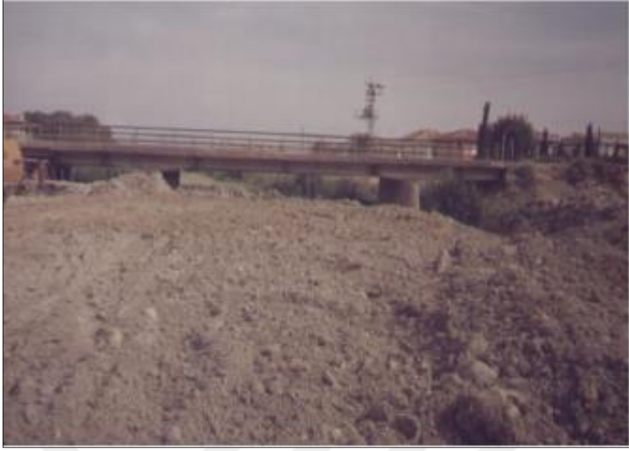
Şekil 1.13. Dere Yatağına Malzeme Yığılması
