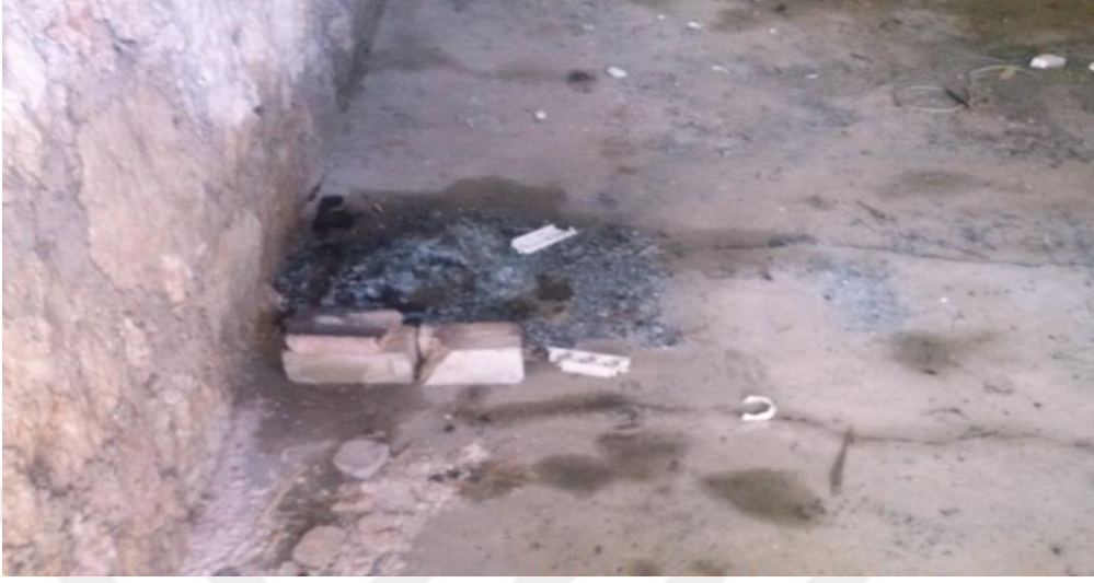
Şekil 4.10. Un fabrikasında bulunan ateş kalıntısı
