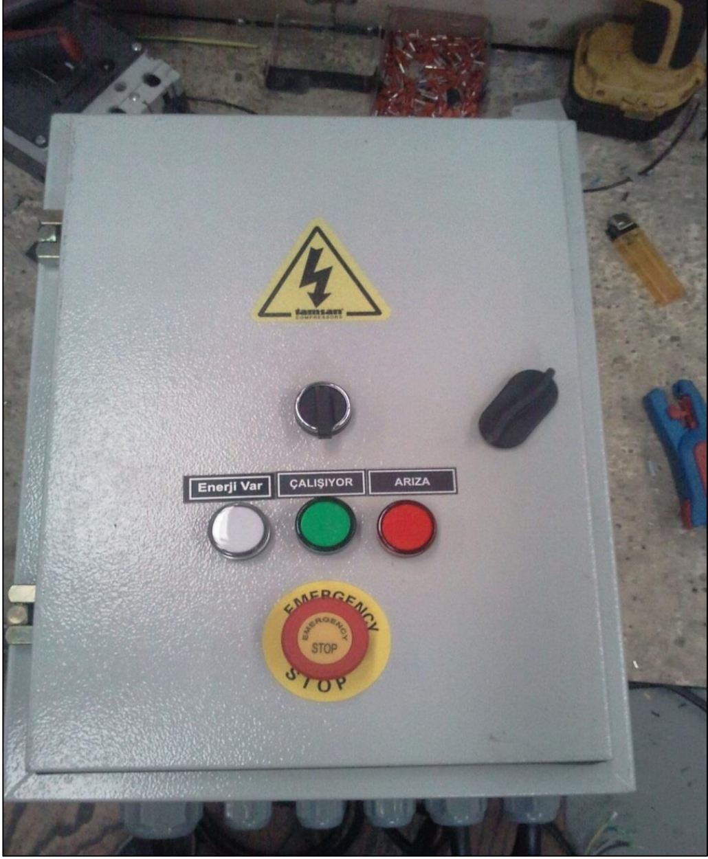
Şekil 3.18. Kompresör elektrik panosu
