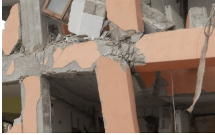
Şekil 1.3. Kocaeli Depremi (1999) sırasında oluşan plastik mafsal örneği
