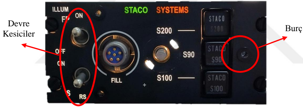
Şekil 7. Kontrol Paneline Önden Bakış
