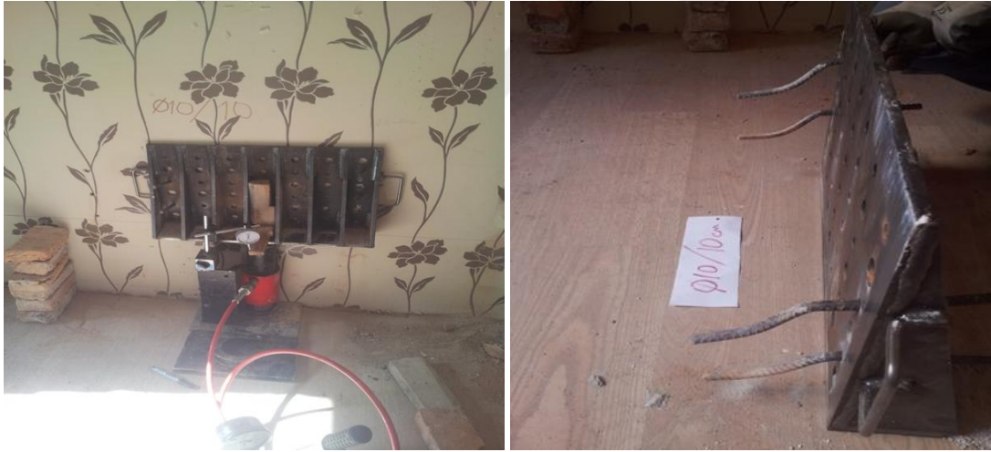
Şekil 3.1. Ø10'luk ankrajlara uygulanan kuvvet sonrası ankrajlarda oluşan hasar
