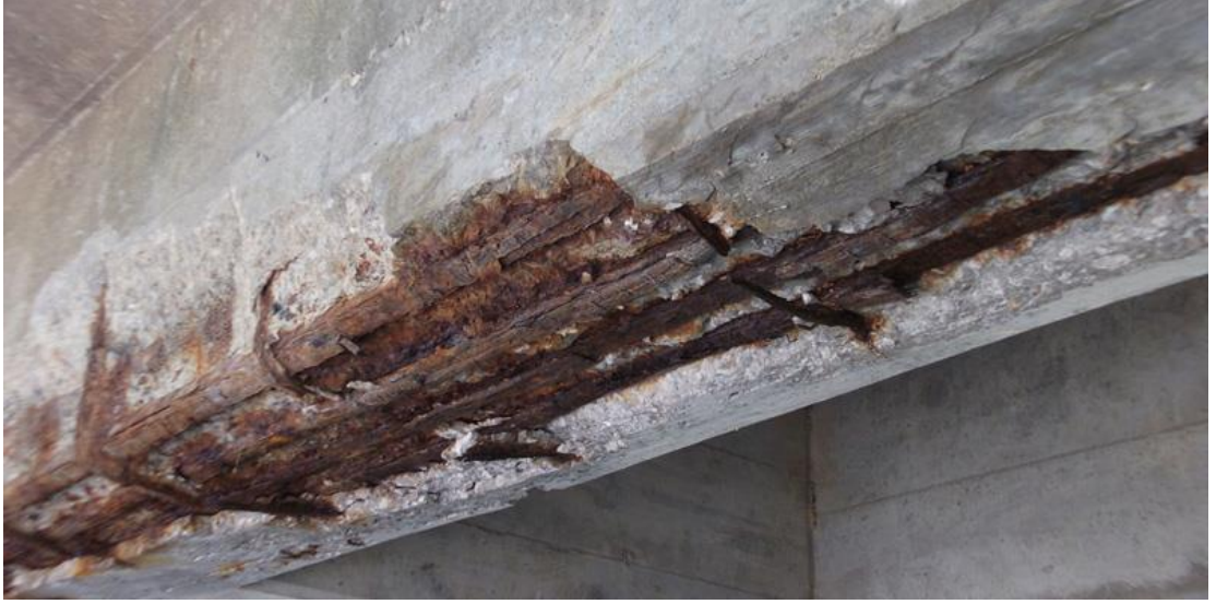
Şekil 1.2. Korozyon sebebiyle tahrip olmuş bir kiriş
