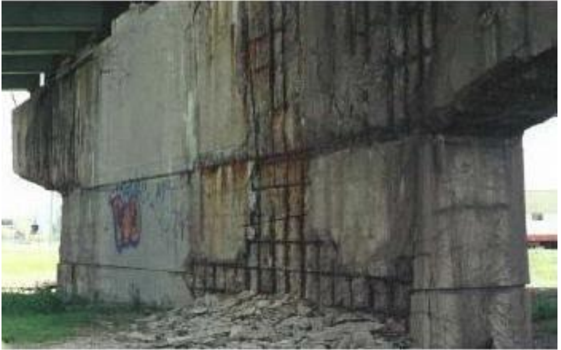
Şekil 1.1. Korozyon sebebiyle tahrip olmuş bir köprü ayağı
