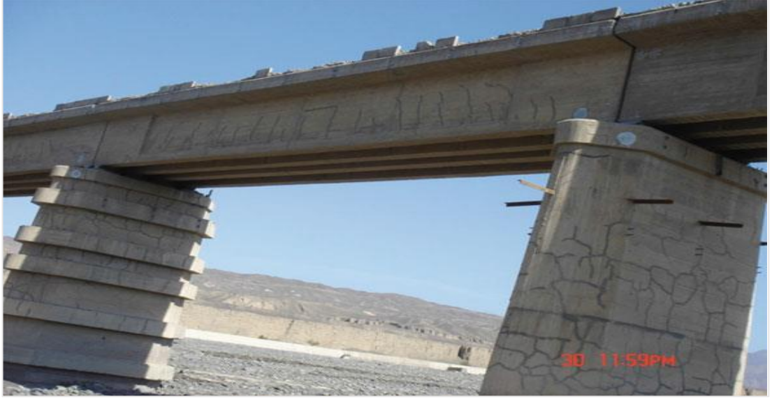
Şekil 2.28. Köprü ayaklarında oluşan kuruma rötresi çatlakları [91].
