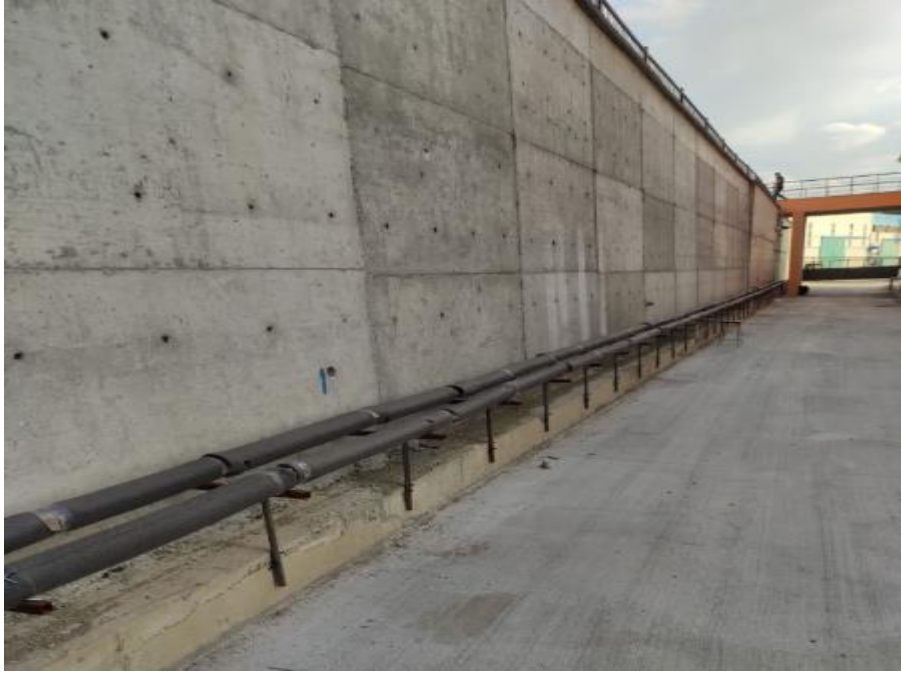
Şekil 4.11. Kompresör boruları görünümü
