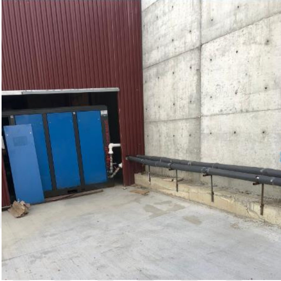
Şekil 4.10. Kompresör yerinin dışarıdan görünümü
