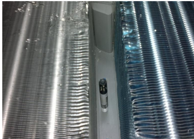
Şekil 3.7. Hava hattında yoğuşturucu ile buharlaştırıcı arasına yerleştirilmiş bir adet Michell marka nem ve sıcaklıkölçerin genel görünümü
