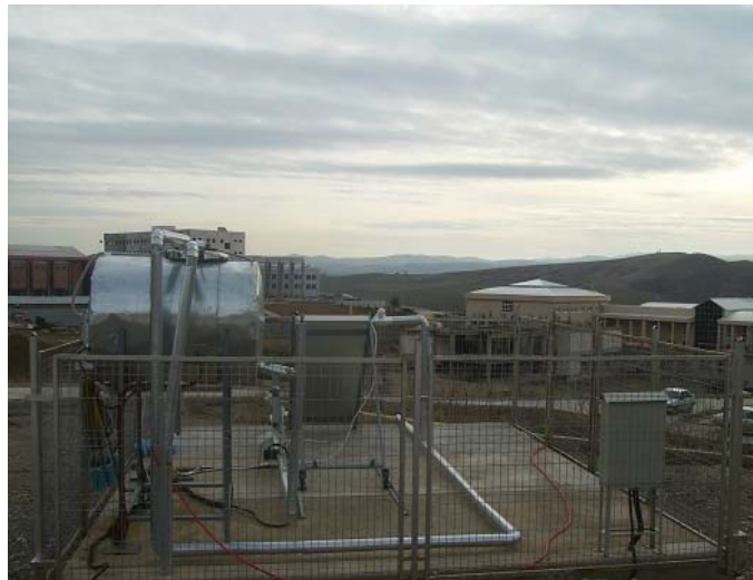
Şekil 7.3.d. Deney tesisatı arka görünüşü
