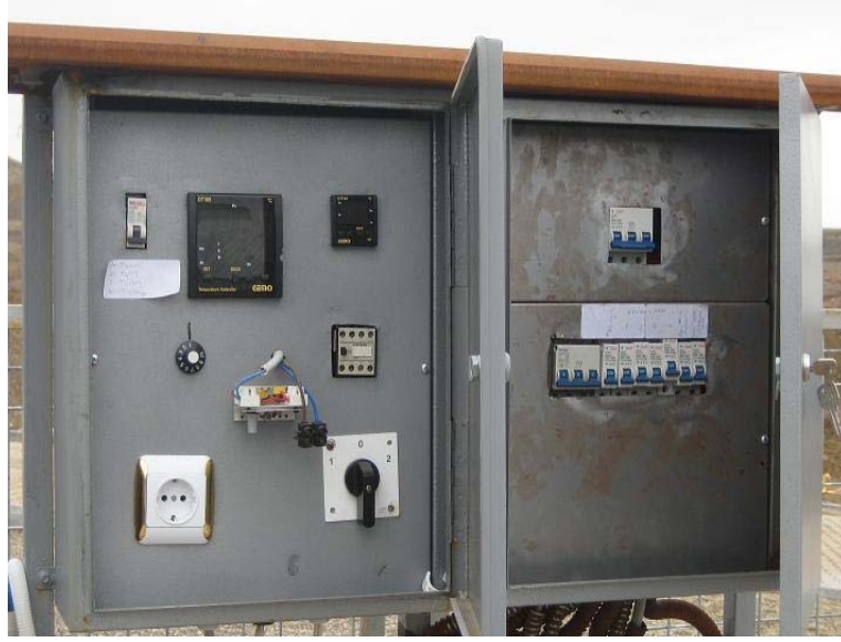
Şekil 7.2. Deney tesisatı panoları
