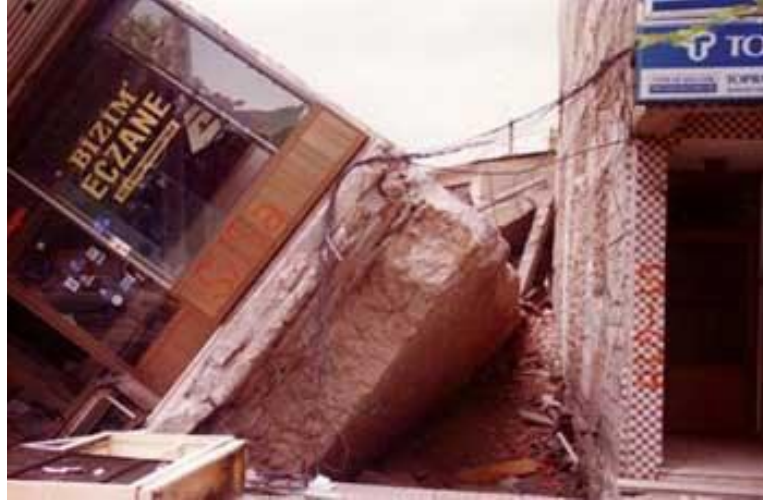
Şekil 5.7. B=4,00 Metre, H=16,00 Metre Olan Binanın Devrilmiş Hali-3
