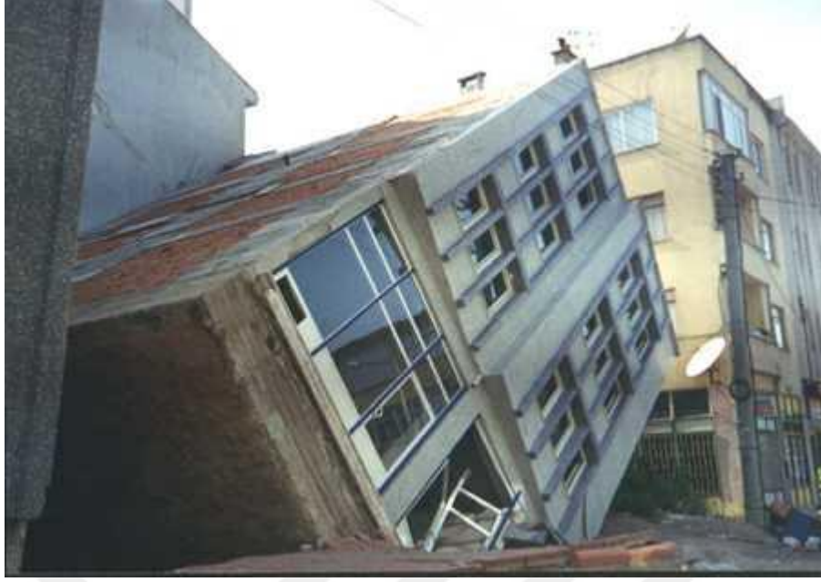
Şekil 5.13. Dar Cepheli Bir Binanın Devrilmiş Hali
