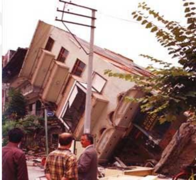
Şekil 5.6. B=4,00 Metre, H=16,00 Metre Olan Binanın Devrilmiş Hali-2
