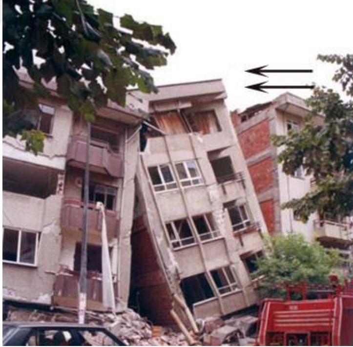
Şekil 5.10. Dar Cepheli Bir Binanın Devrilmiş Hali
