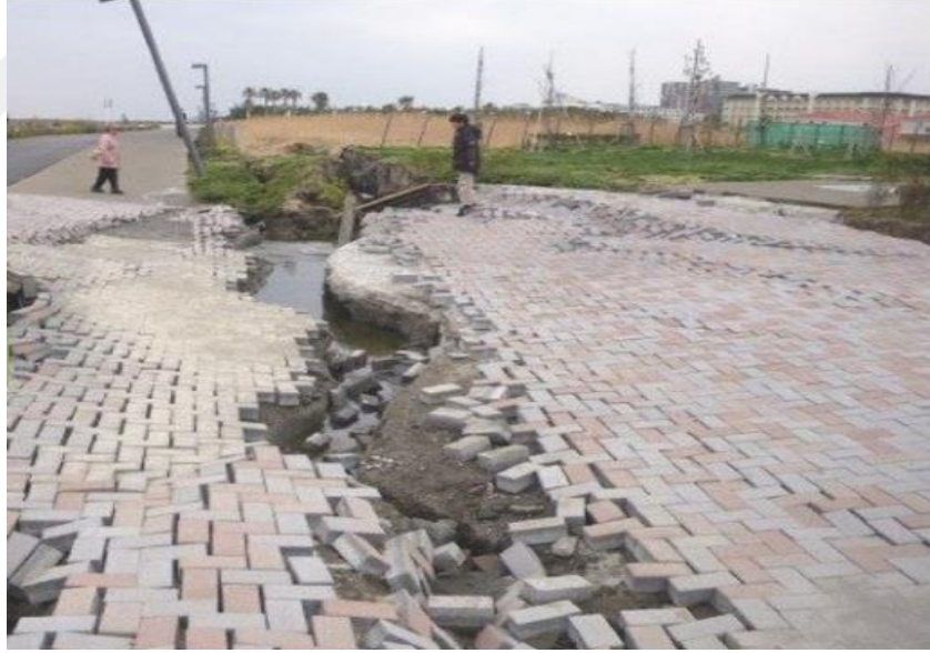
Şekil 5.17. Depremde Sıvılaştan Zeminden Yukarı Çıkan Su Ve Ayrışan Zemin
