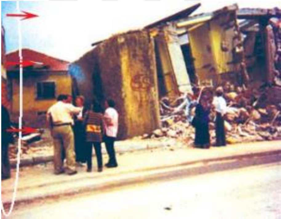
Şekil 5.8. Dar Cepheli Bir Binanın Devrilmiş Hali
