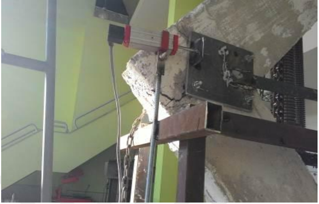
Şekil 3.9. 99 kN yükte oluşan hasar
