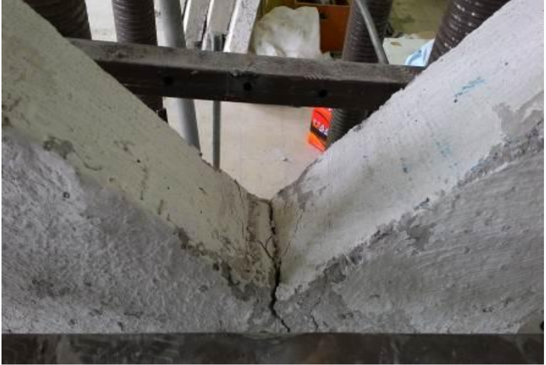
Şekil 3.34. Göçme anında oluşan hasar
