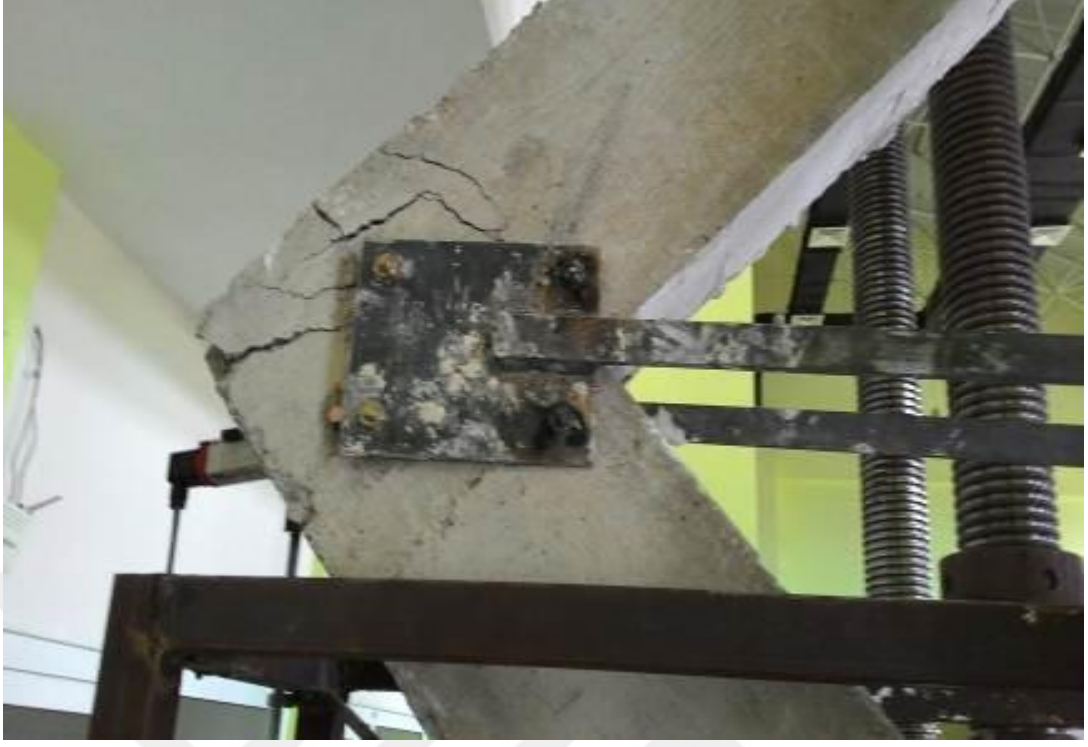
Şekil 3.35. Göçme anında oluşan hasar
