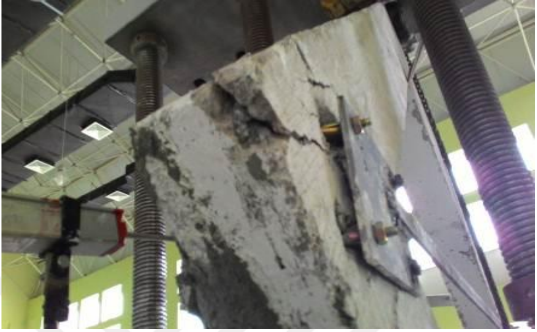
Şekil 3.33. Göçme anında oluşan hasar
