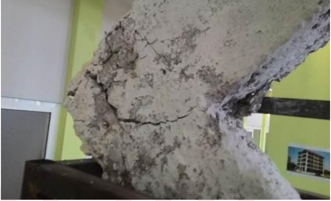
Şekil 3.26. Göçme anında oluşan hasar
