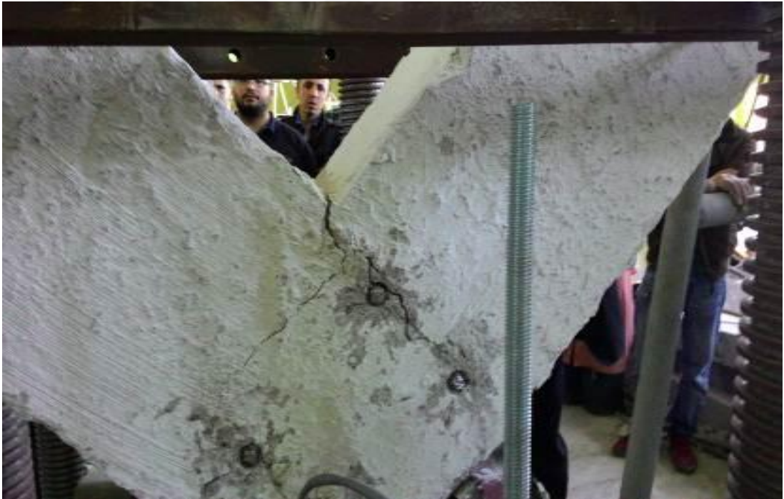
Şekil 3.13. Maksimum yükleme sonrası alt birleşim bölgesinde oluşan hasar
